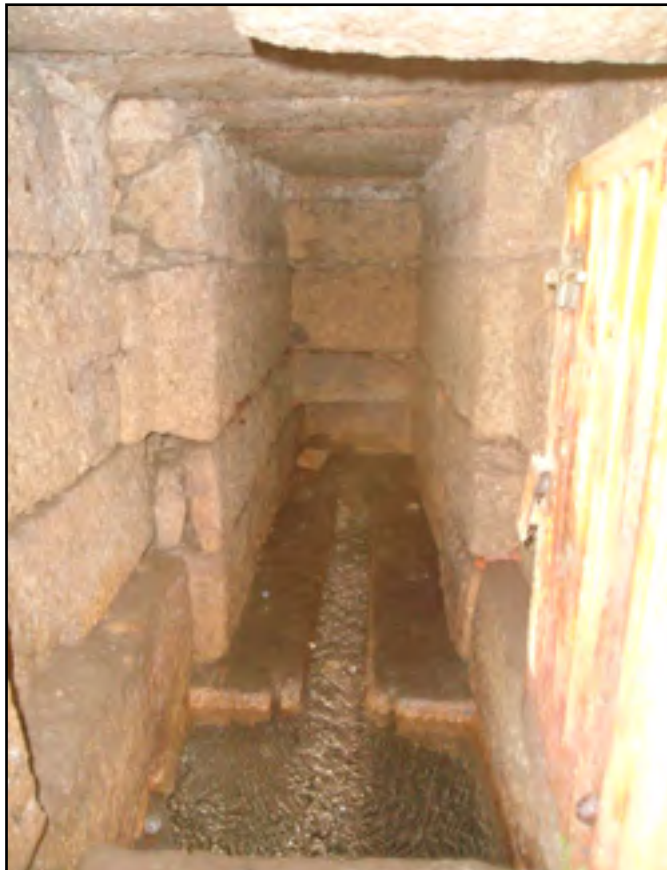
Interior do punto confluencia das augas de captación. Apréciase a canle do manancial que achega o caudal.
