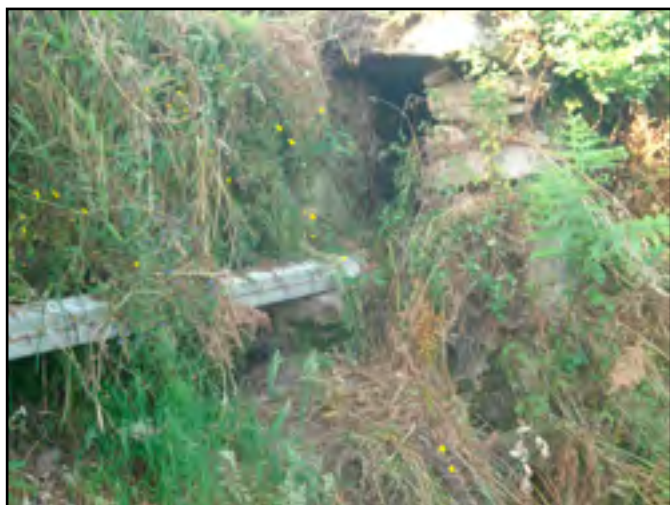
Estado actual de deterioro e abandono.
